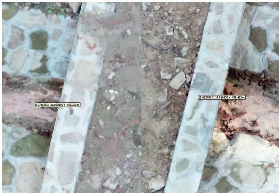
Ryc. 19. Współrzędne przestrzenne wylotu (z lewej) i wlotu (z prawej) przepustu rurowego (źródło: program Agisoft PhotoScan)
