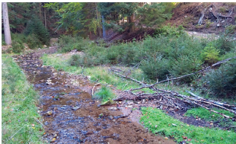
Ryc. 3. Widok na załadowisko i przelew zapory od strony górnej wody (a) oraz w przeciwnym kierunku, po prawej stronie widoczna droga dolinowa (fot. P. Huskiewicz)
