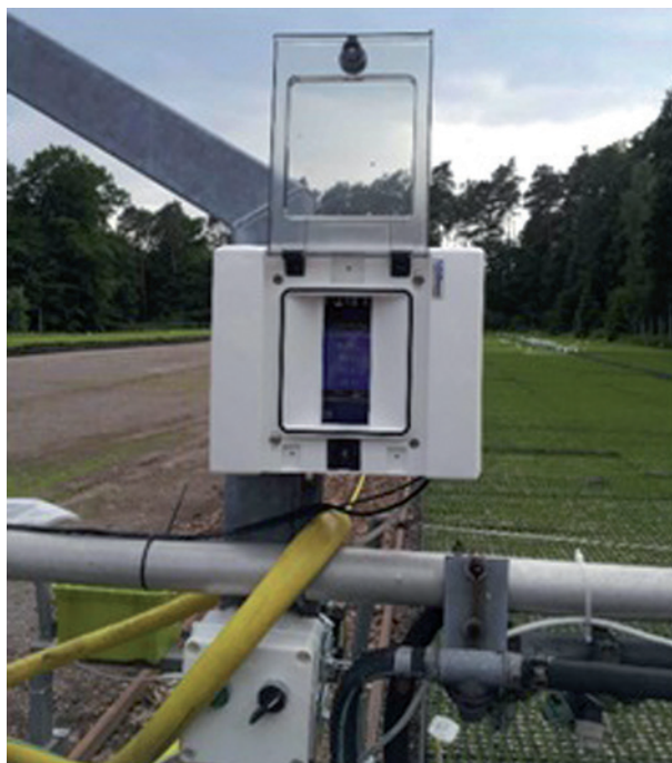
Ryc. 5. a) System monitorowania pH oraz konduktancji zamontowany na wózku jezdnym rampy deszczującej na szkółce, czujniki; b) Rejestrator Elmetron (fot. G. Durło)
