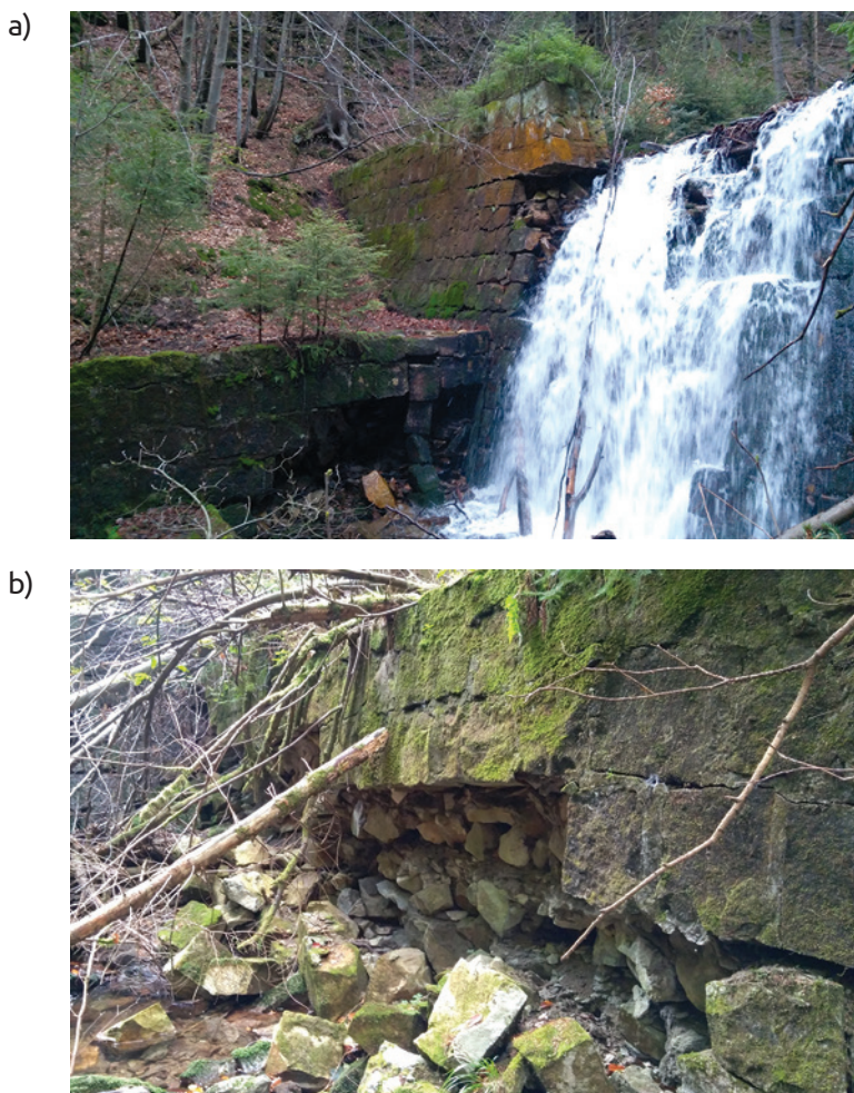
Ryc. 2. Zniszczona gardziel przelewu (a) oraz fragment ściany bocznej (b) (fot. P. Huskiewicz)
