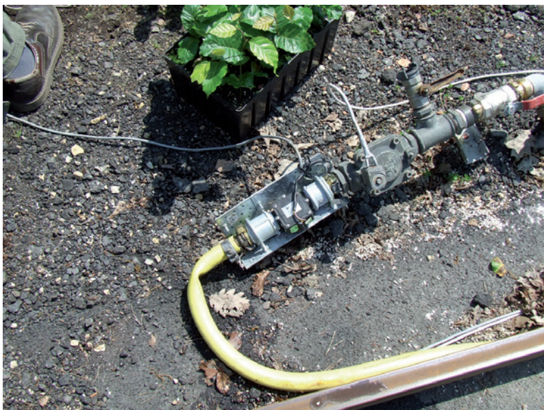
Ryc. 4. Czujnik pomiaru wody w rampie deszczującej zamontowany w rurze zasilającej deszczownię (fot. M. Kormanek)
